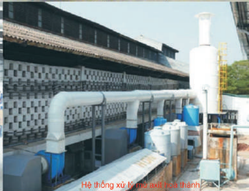
Hệ thống xử lý mùn axit hóa thành
